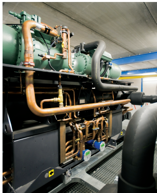
De energiecentrale Thermo Bello in de duurzame woonwijk Eva Lanxmeer in Culemborg
